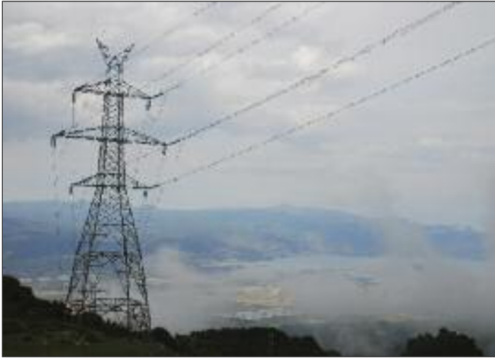
Η «τετρακοσάρα» (Γραμ. Μεταφ. 400.000V) ανεβαίνει στο Καλλίδρομο. Κάτω ο Μαλιακός, Φωτ. Γιώργ. Γκλέτσος ▲
